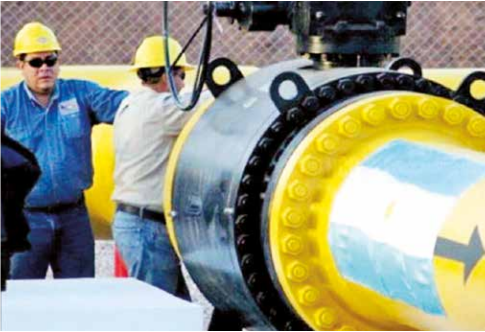
El ducto de exportación de gas de Bolivia hacia Argentina. LOS TIEMPOS
